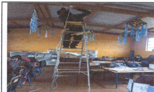
Foto 4: Sustrucción de cableado eléctrico
