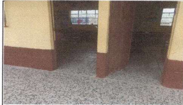
Foto 2: Sustrucción de cemento líquido por piso de granito
