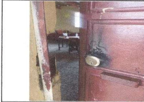
Foto 1. Sustrucción de chapa puerta aula No. 1, 2, 3 y 4
